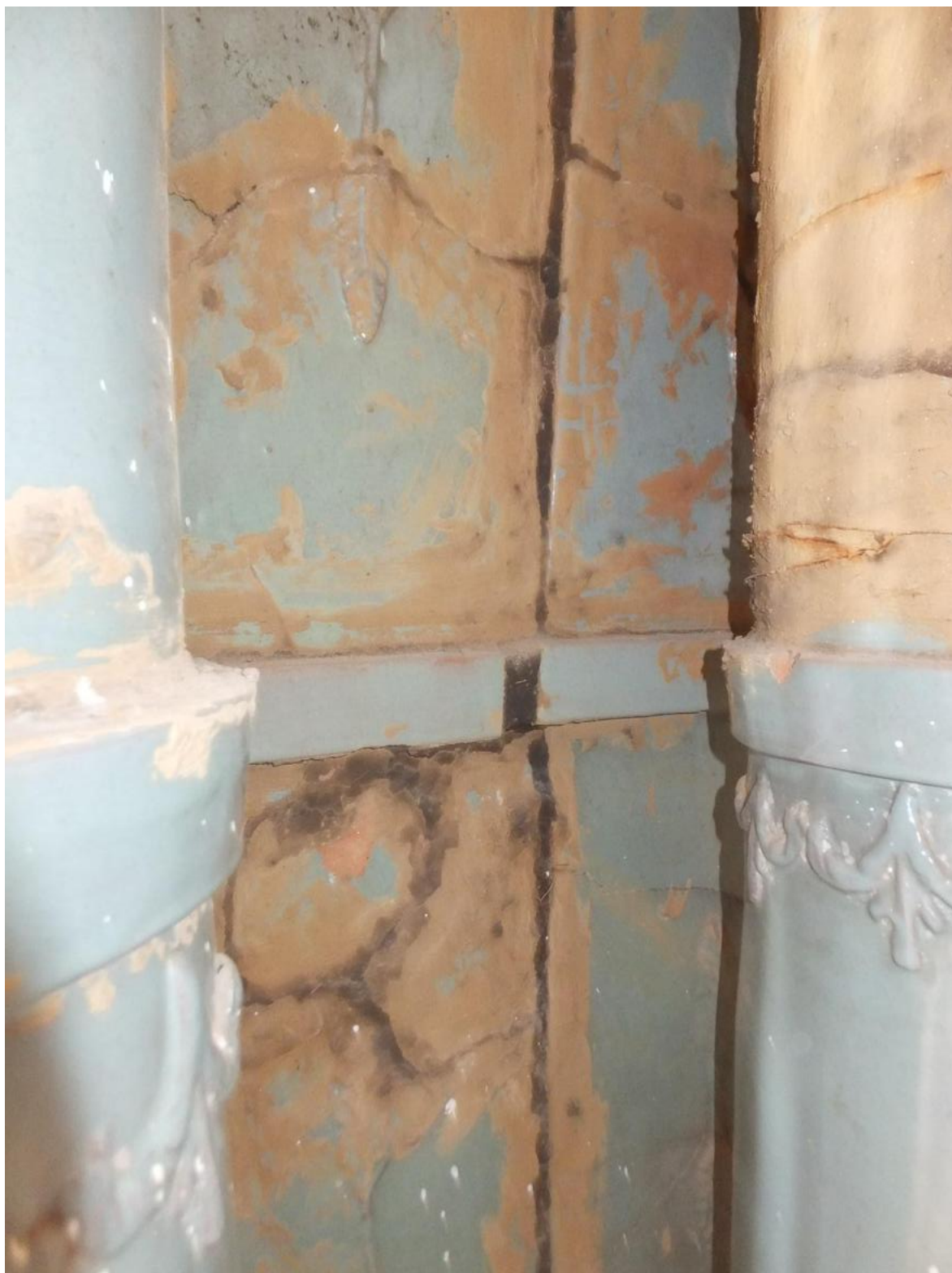
4. Detailný pohľad na pravú stranu pece
