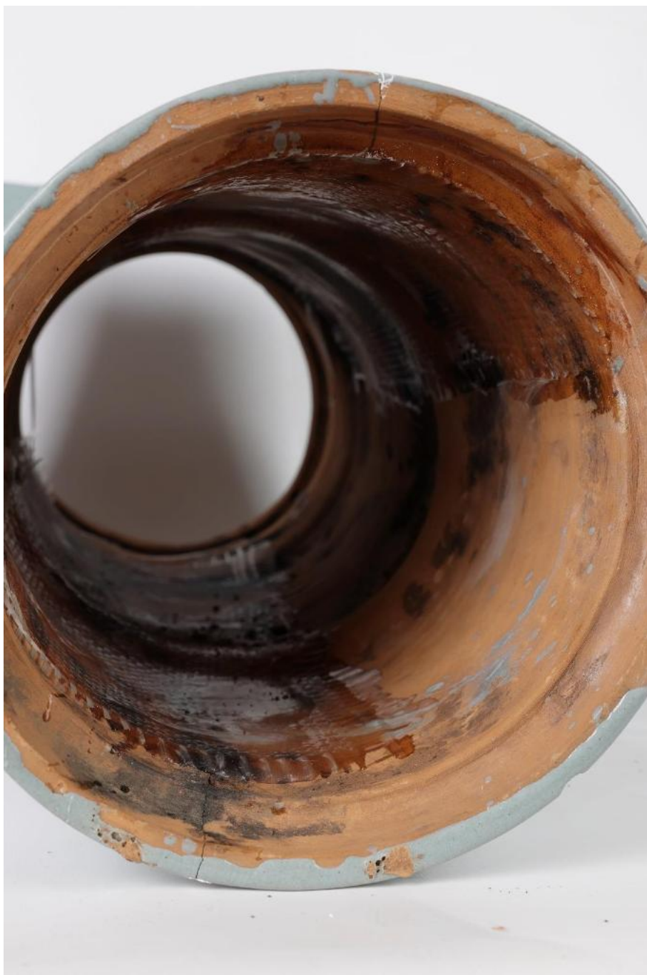
102. Prasknutá stĺpová kachlica musela byť z vnútornej strany spevnená laminátom.
