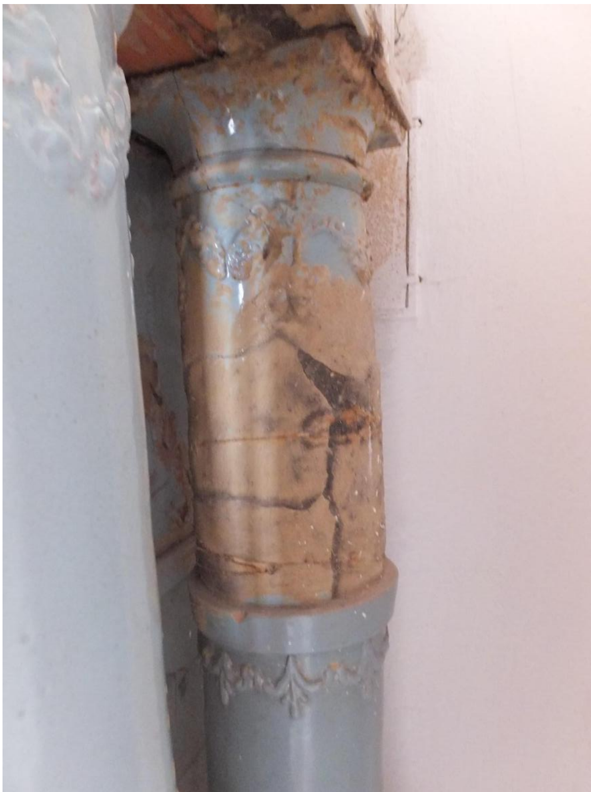
3. Pohľad na pec z pravej strany. Horná časť stĺpu je silne poškodená
